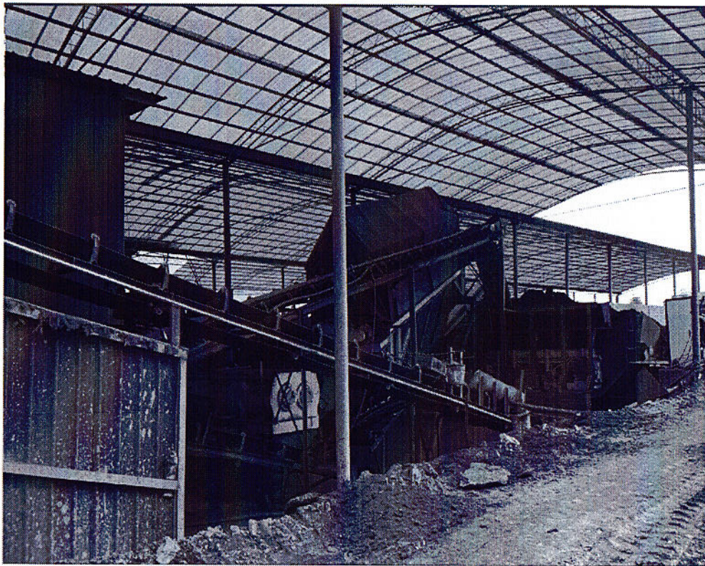
破碎除尘器+车间封闭
