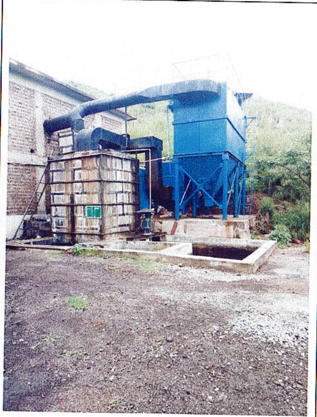
锅炉布袋除尘器
