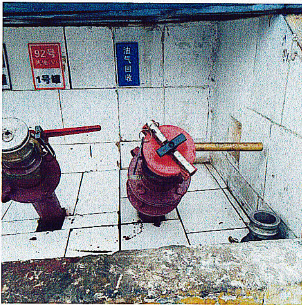
油气回收装置
