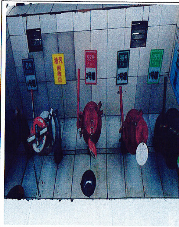
油气回收装置
