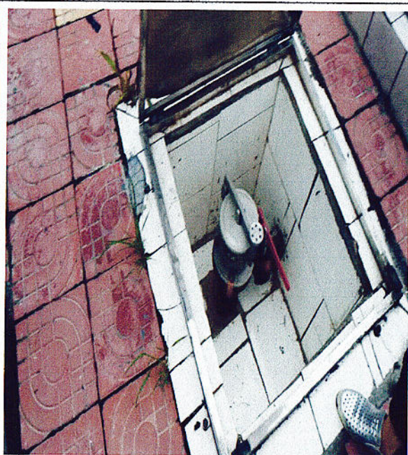
油气回收装置
