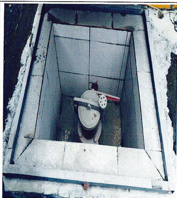
油气回收装置
