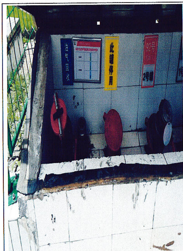
油气回收装置
