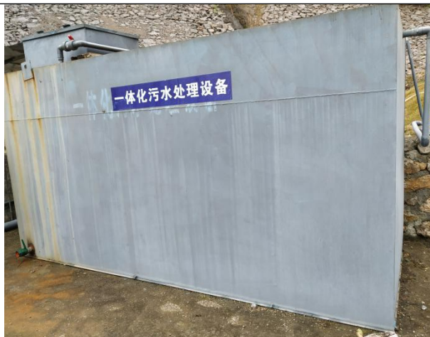
污水处理设备
