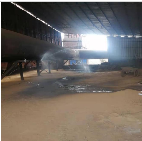
除尘灰堆场喷淋
