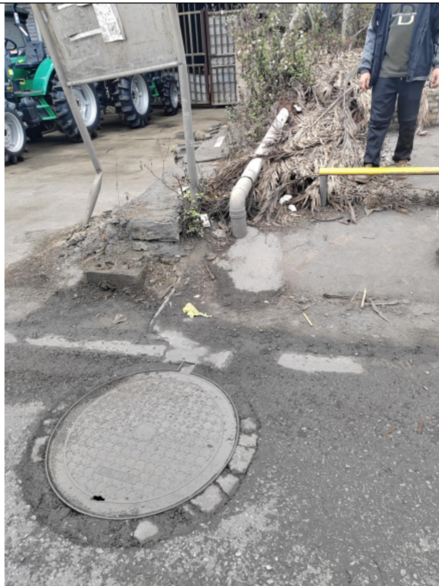
生活污水排放口
