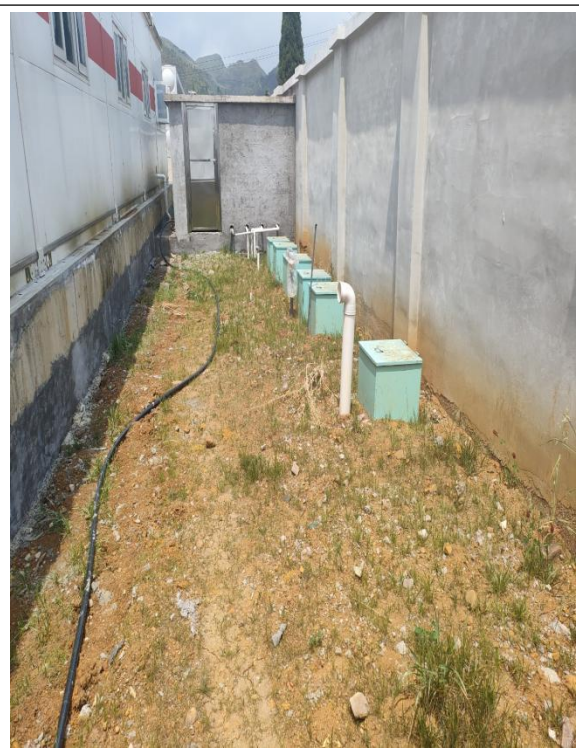
地理式污水处理站
