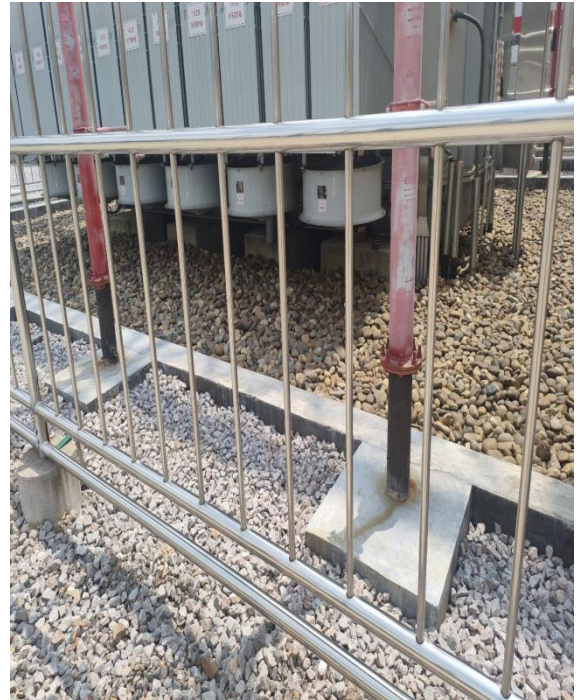
主变事故围堰
