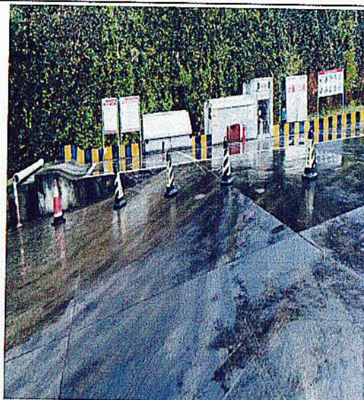
油气回收装置
