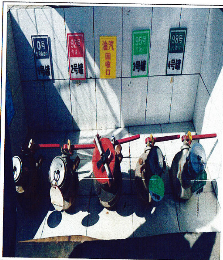
油气回收装置
