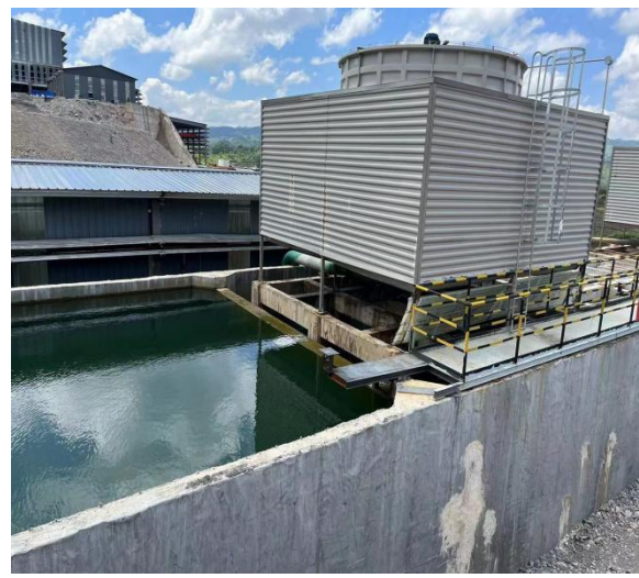
冷却循环水塔
