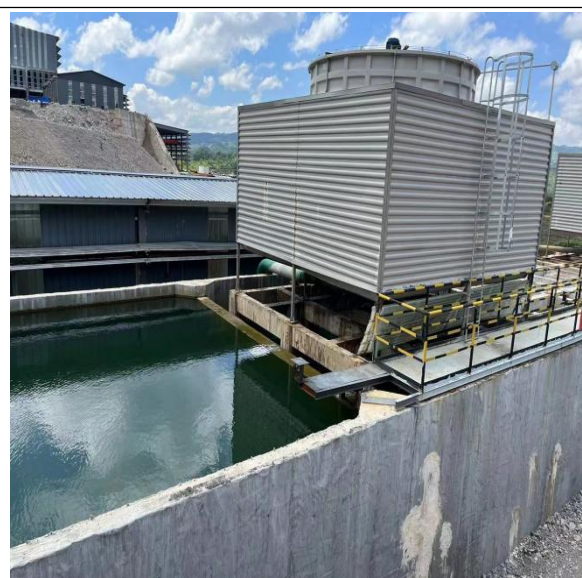
冷却循环水塔
